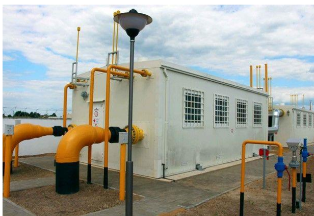
Рис. 37- Автоматическая газораспределительная станция
