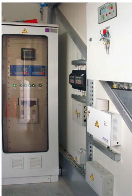
Рис. 43- Узел автоматического управления.
