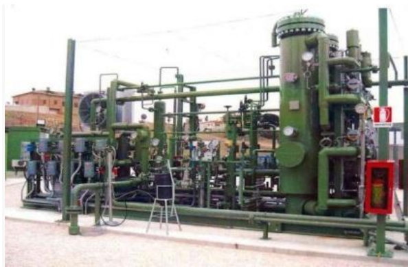
Рис. 41- Установка осушки газа.
